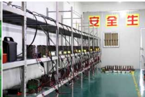
Fábrica de baterías Li-Ion de EP Equipment
